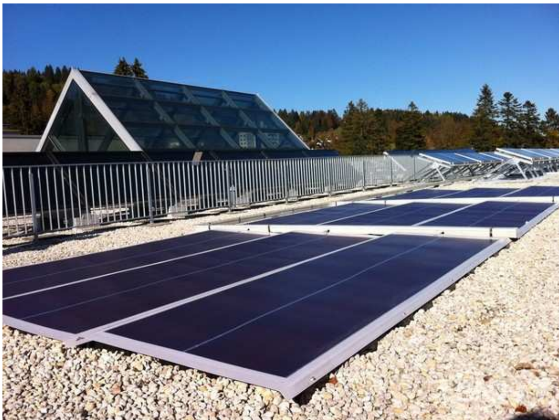
Les panneaux solaires sur le toit du Lycée Blaise-Cendrars
