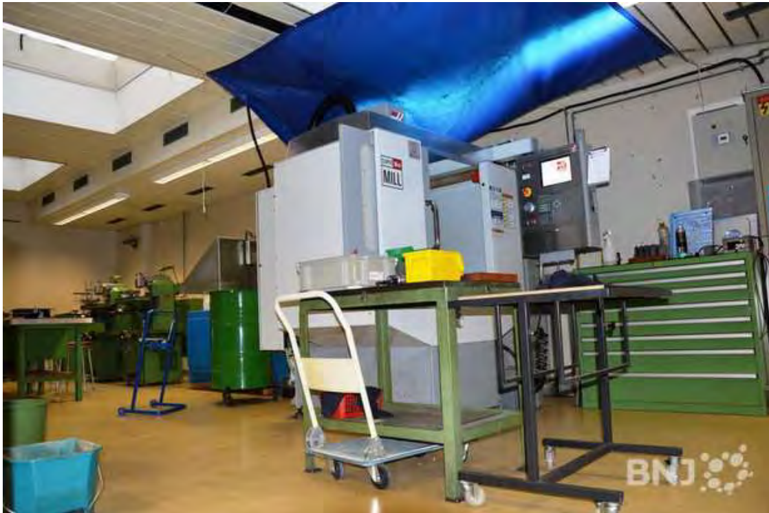
Dans la halle C, la situation est catastrophique: des bâches et des seaux d'eau sont installés pour recueillir l'eau du toit.
