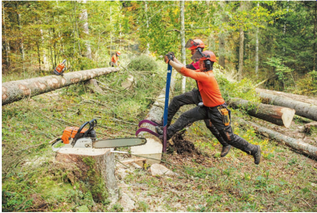
Entre 3000 et 6000 m 3 de bois des forêts de Val-de-Ruz seront utilisés pour le chauffage à distance. C. GALLEY
